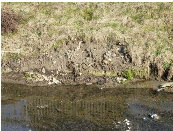
Obr. 4: Břehová nátrž podél toku Zděchovky
