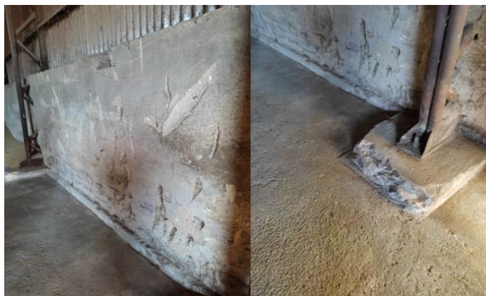
Obrázek 24: Poškození stěn ve skladu S6 (foto autor)
