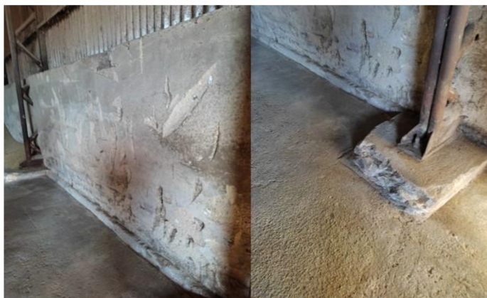
Obrázek 24: Poškození stěn ve skladu S6 (foto autor)
