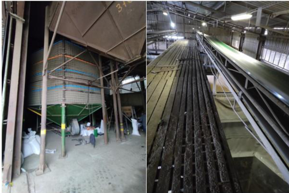
Obrázek 16 : Silo a podstřešní dopravník ve skladu S3 (foto autor)
