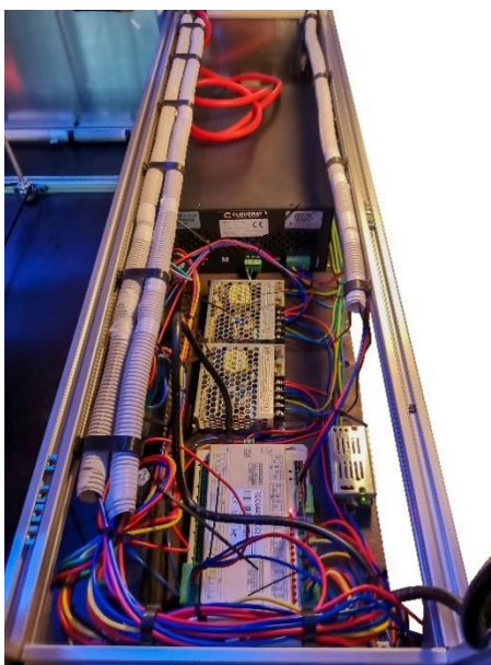
Obr. 51 Zdroje elektrické energie.
