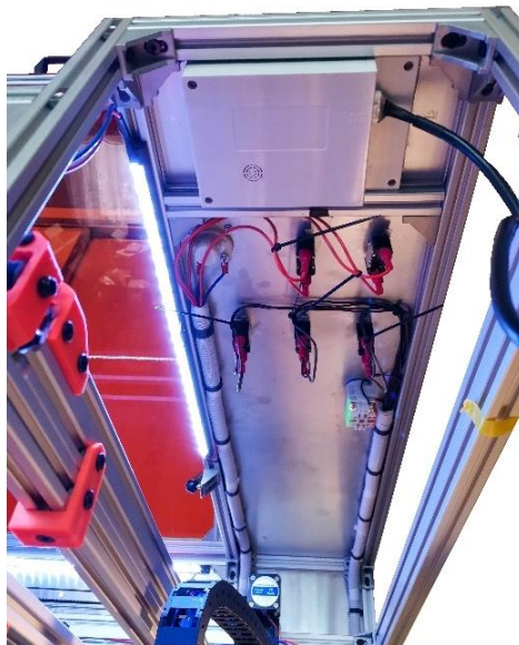
Obr. 56 Vedení kabelového systému.
