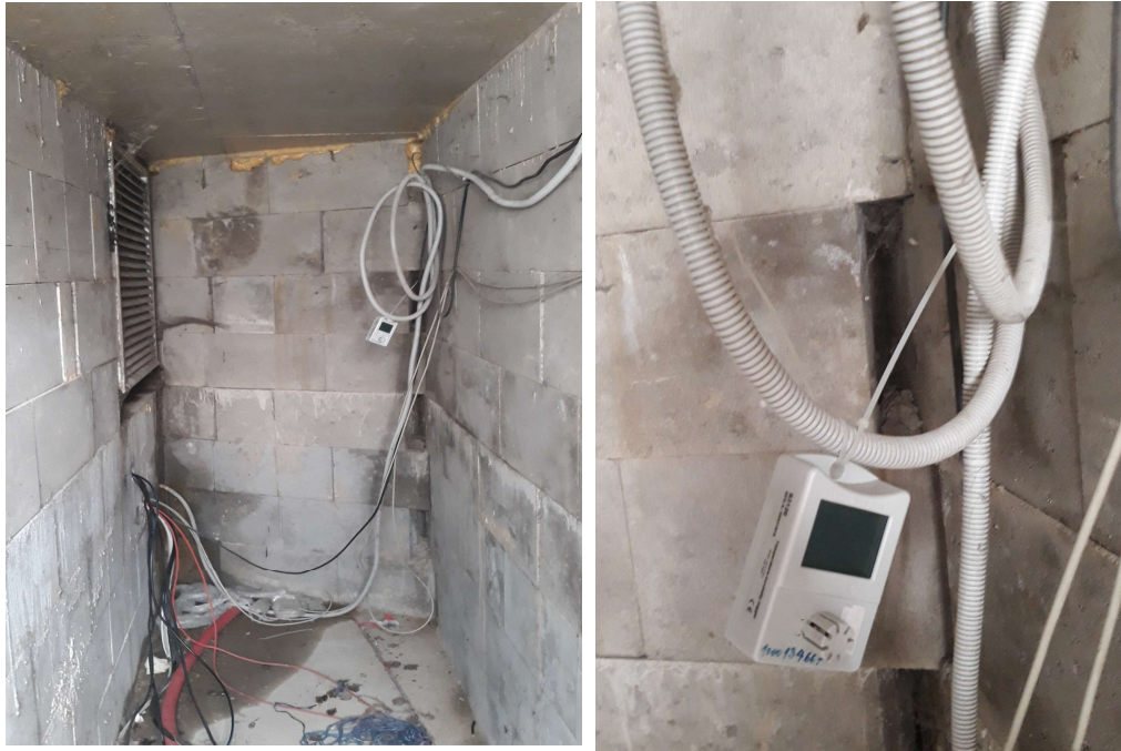
Obrázek 68 – Datalogger Comet umístěný v zemním kanále sání
