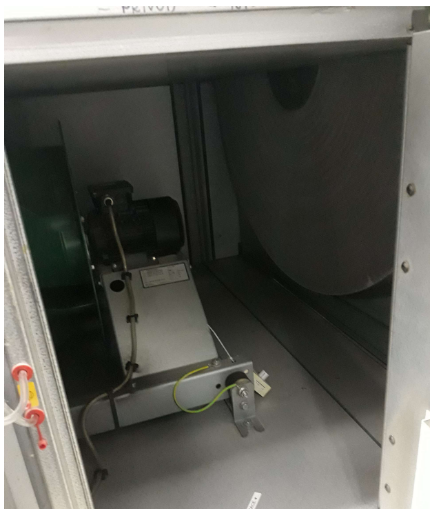
Obrázek 65 – Datalogger Comet v přívodním ventilátoru
