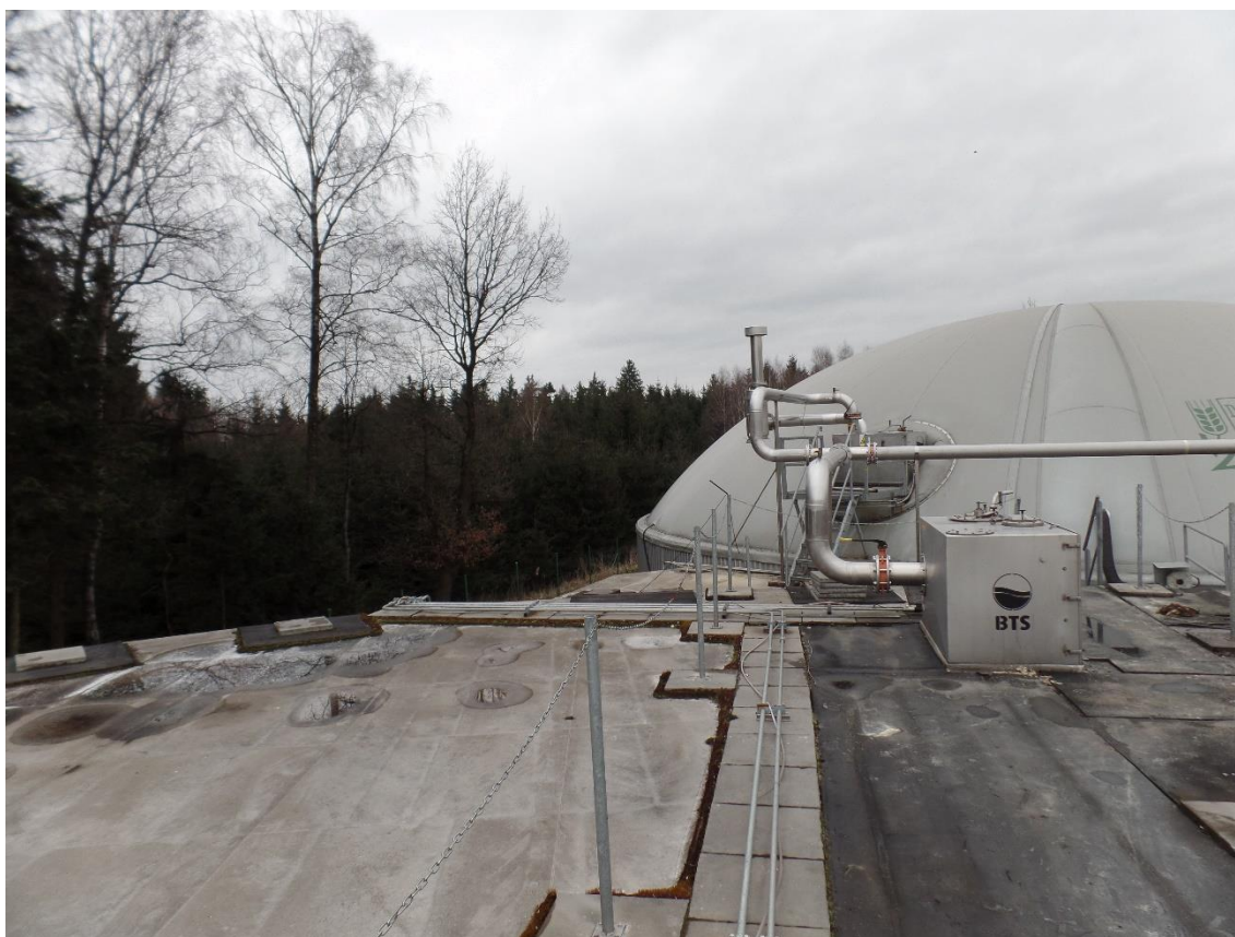
Obr. 6 Betonový strop fermentoru a dofermentor s integrovaným plynojemem
