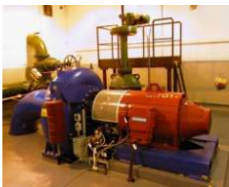
Foto č. 7- Prostory strojovny malé vodní elektrárny Březová – Francisova turbína + generátory
