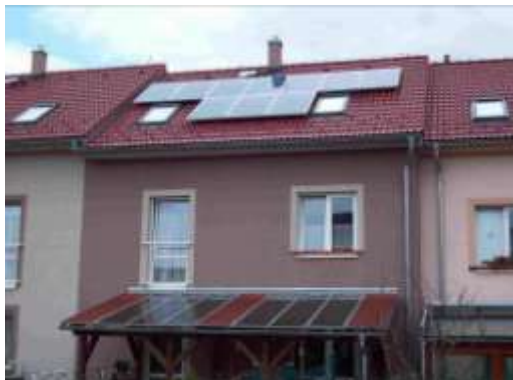
Foto č. 1 – Fotovoltaická elektrárna Stará Role s instalovaným výkonem 5 kW
