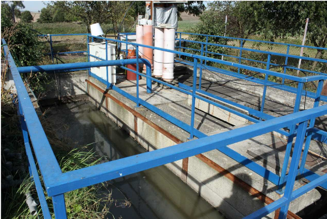
Obr. 5 Štěrbínová usazovací nádrž, KČOV Dražovice
