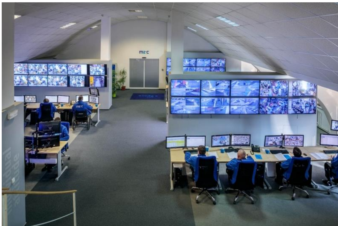
Obrázek 3 – Dohledové centrum společnosti M2C
