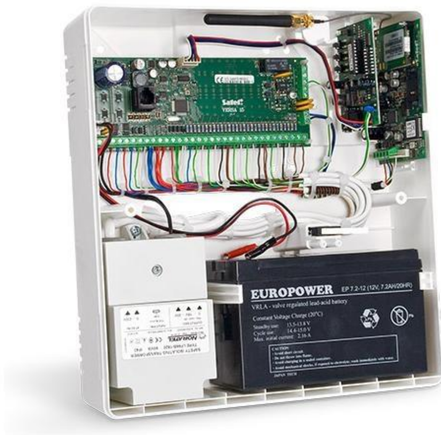
Obrázek 4 – Ústředna elektronického zabezpečovacího systému
