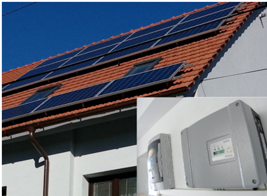
Obrázek 5 Instalované FV panely a měnič napětí
