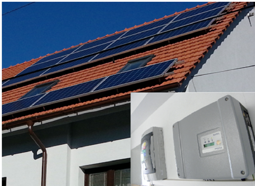
Obrázek 5 Instalované FV panely a měnič napětí
