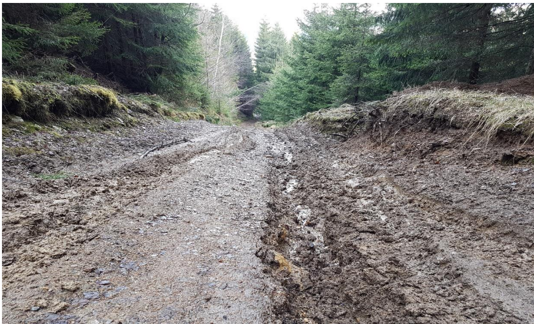
Obr. 21: Lesní cesta poškozená povrchovou vodní a těžebně-dopravní erozí (Daniel Sural, 2022)
