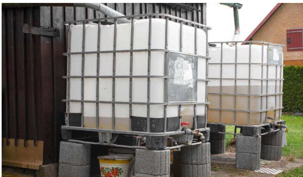
Obrázek 7: Nadzemní nádrže na dešťovou vodu (Green-wiki,2017)
