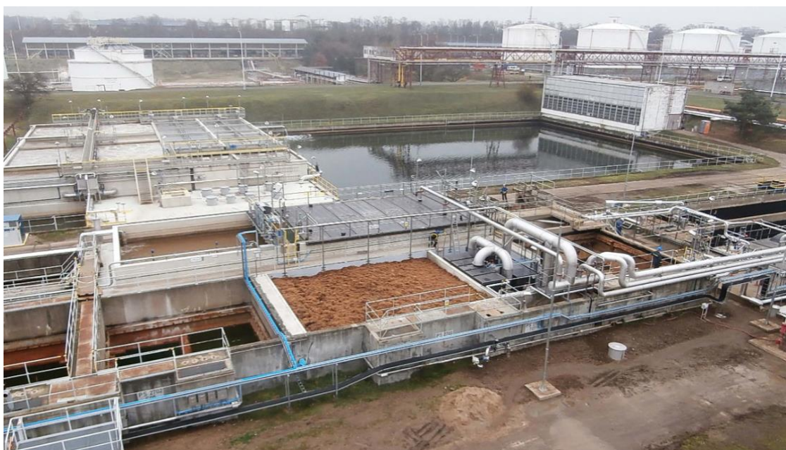
Obrázek 5: ČOV Česká rafinérská, a.s. Kralupy nad Vltavou (Časopis stavebnictví,2017)
