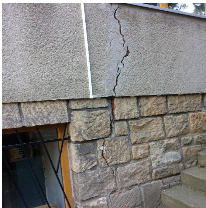
Obrázek 17 - Detail trhliny oddělující podsklepenou a nepodsklepenou část objektu
