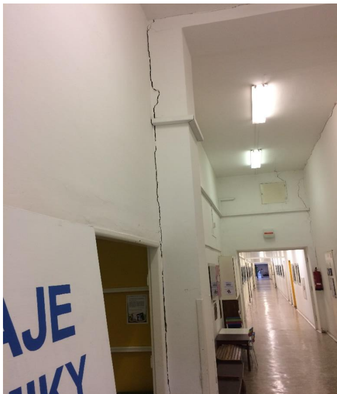
Obrázek 16 - Trhlina oddělující nenosnou zeď od stabilizačního sloupu
