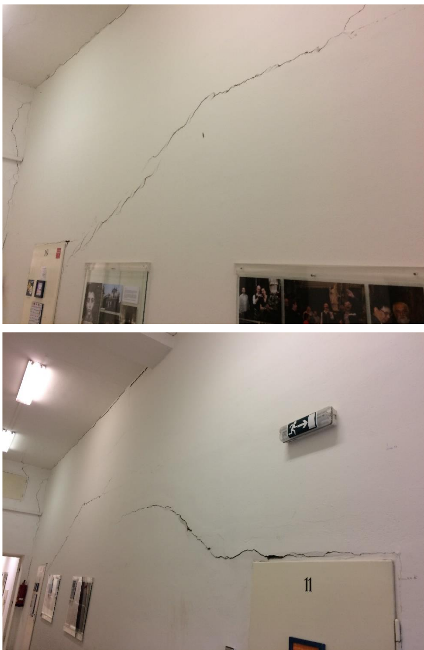
Obrázek 15 - Síť trhlin v nenosné zdi spojovací chodby
