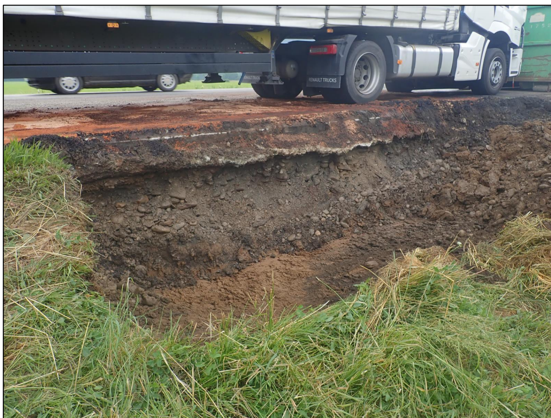
Obr. 75 Vybagrovaná část kontaminované půdy palivem při dopravní nehody mezi Vsetínem a Ústí v roce 2021 Zdroj: Javoříková (2021)
