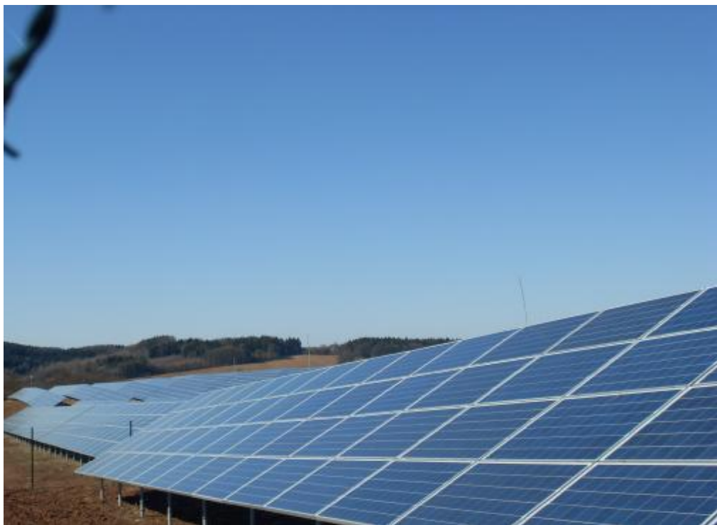
Příloha č. 4: Pohled na fotovoltaické panely vyrábějící elektrickou energii.
