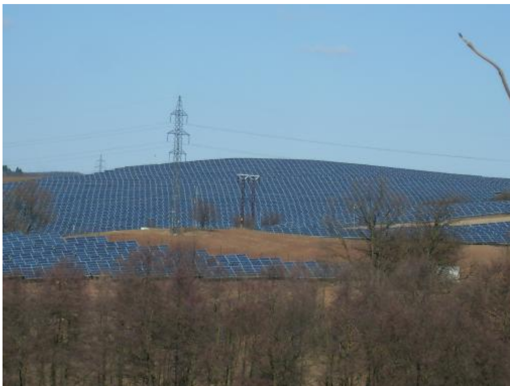
Příloha 5: Fotovoltaická elektrárna Chrudichromy s výkonem 10 000 kWp. Umístění kopíruje reliéf svahu (snímek pořízen od obce Chrudichromy).
