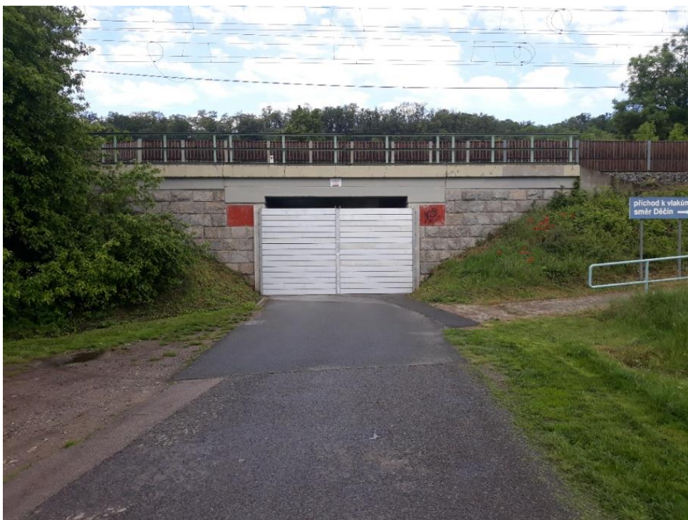
Obr. č. 4 – zahrazení podjezdu mobilními protipovodňovými hradítky na k. ú. Nové Ouholice (foto r. 2020 suchá zkouška); zdroj: starosta obce
