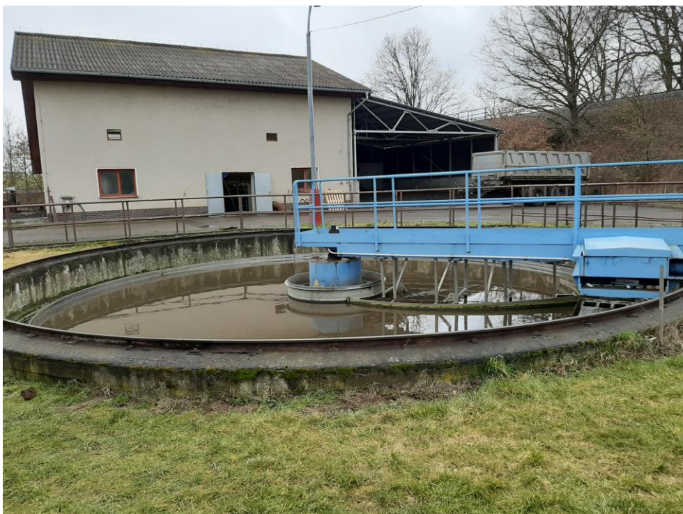
Obr. 3: Dosazovací nádrž – ČOV Březnice (Wagnerová, 2020)
