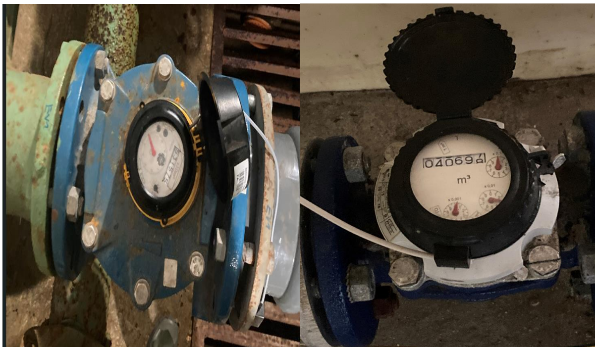
Obr. 1. 16 Měření průtoků v AK vodojemu (vlevo) - Měření průtoků v ATS Poličná – Úlehla (vpravo)
