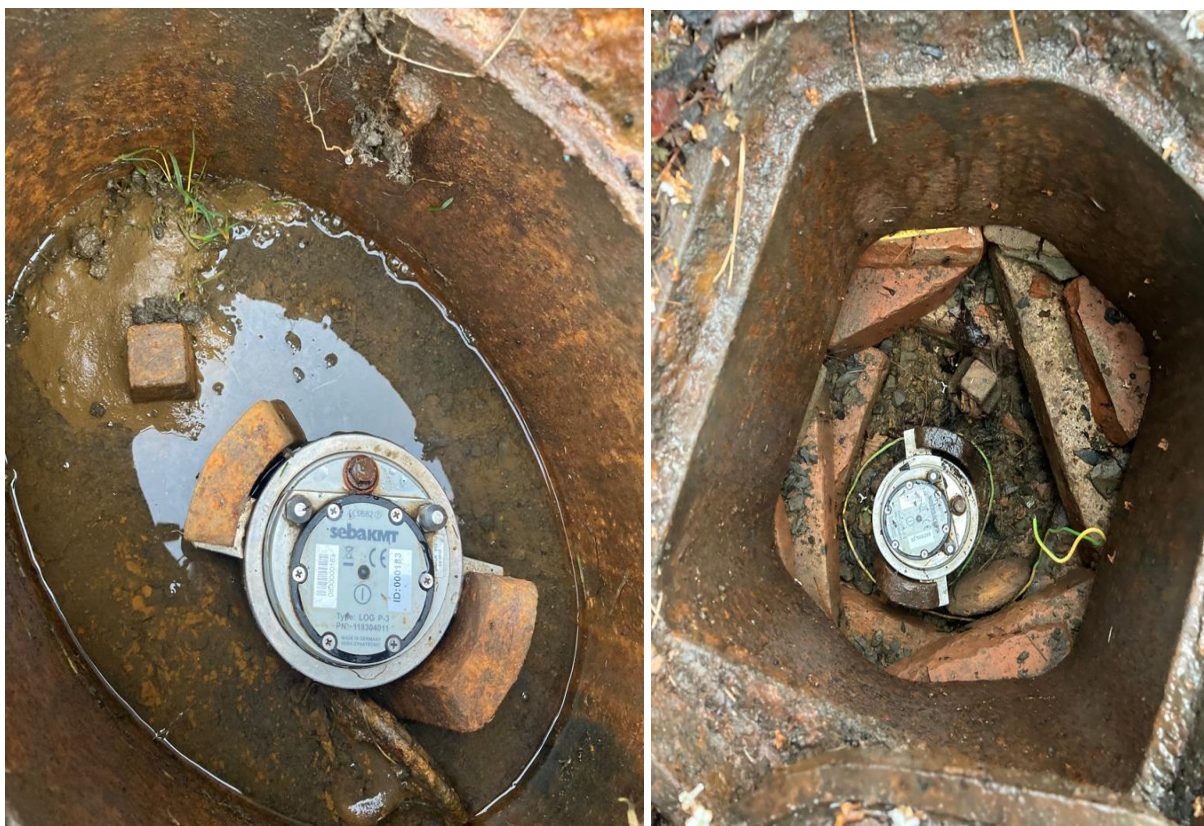
Obr. 1. 20 Osazená čidla na podzemním hydrantu
