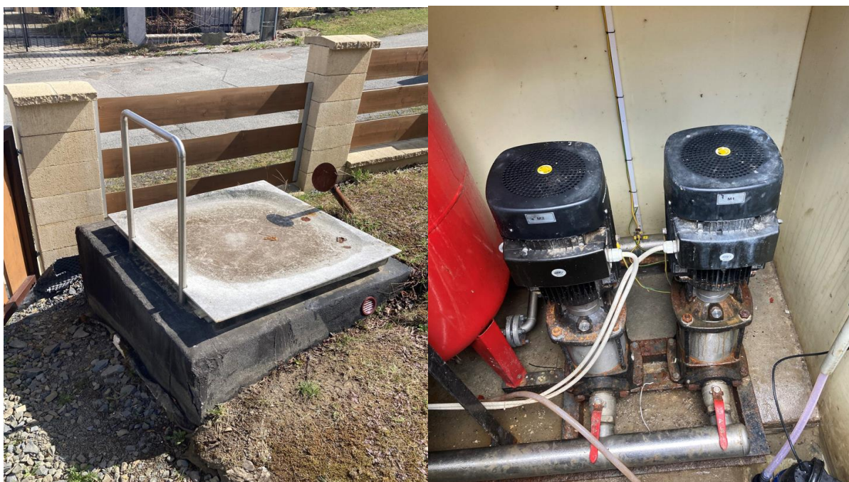
Obr. 1. 14 Pohled na ATS Poličná - Úlehla
