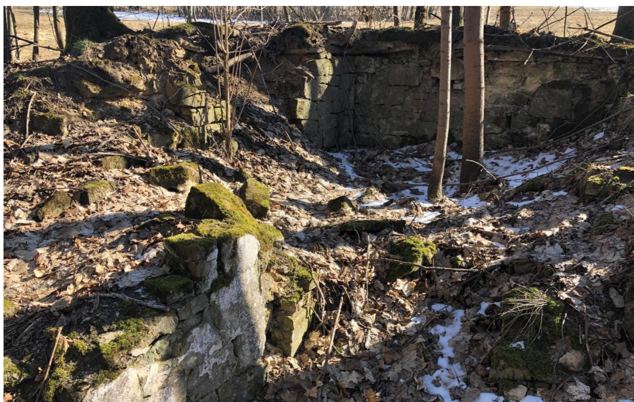
Obrázek 52: Detail rozpadlého domu č. 131, 2022. (zdroj: autor)
