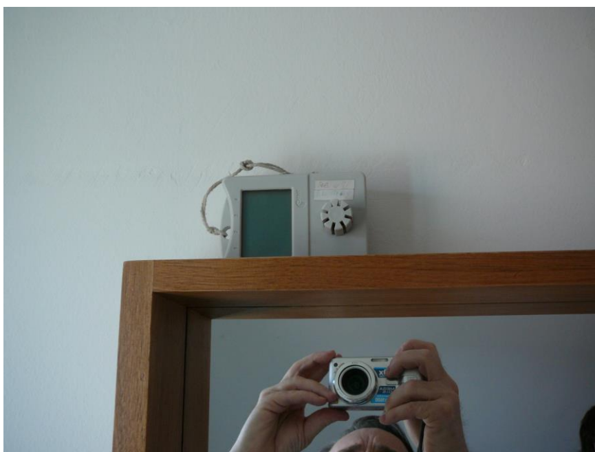
Foto č. 4 Pohled na umístění dataloggeru v objektu RD 2
