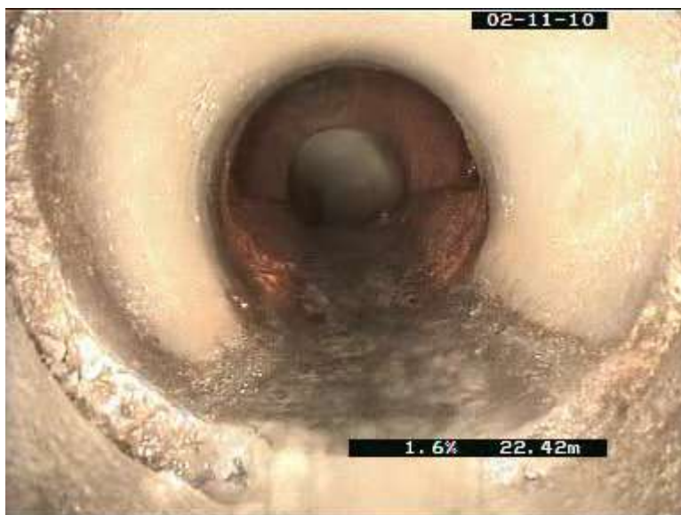
Foto č. 7 – přesazený a nedoražený spoj.
