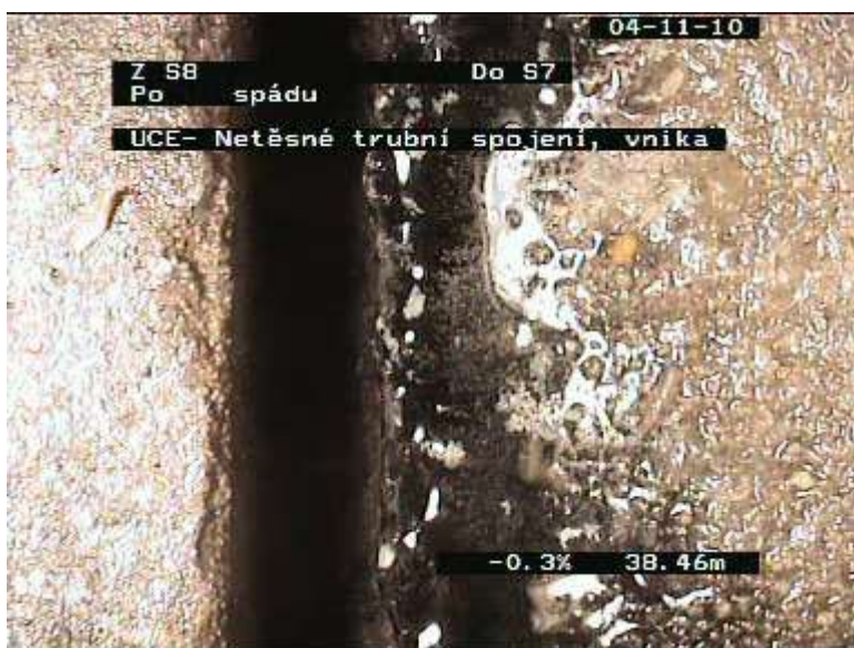
Foto č. 4 – netěsný spoj.
