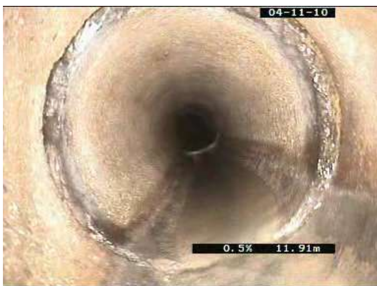
Foto č. 2 – netěsný nedoražený spoj potrubí. Zdroj: z videozáznamu VAS.
