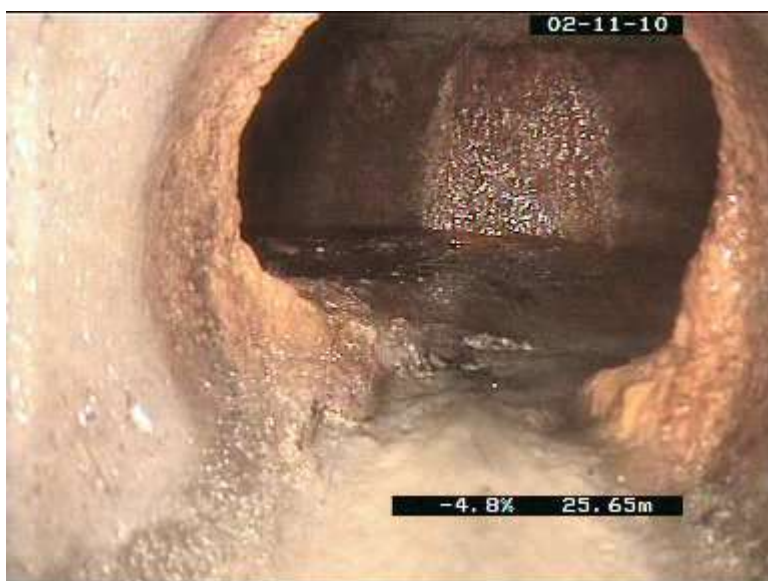
Foto č. 6 - netěsné dno šachty.
