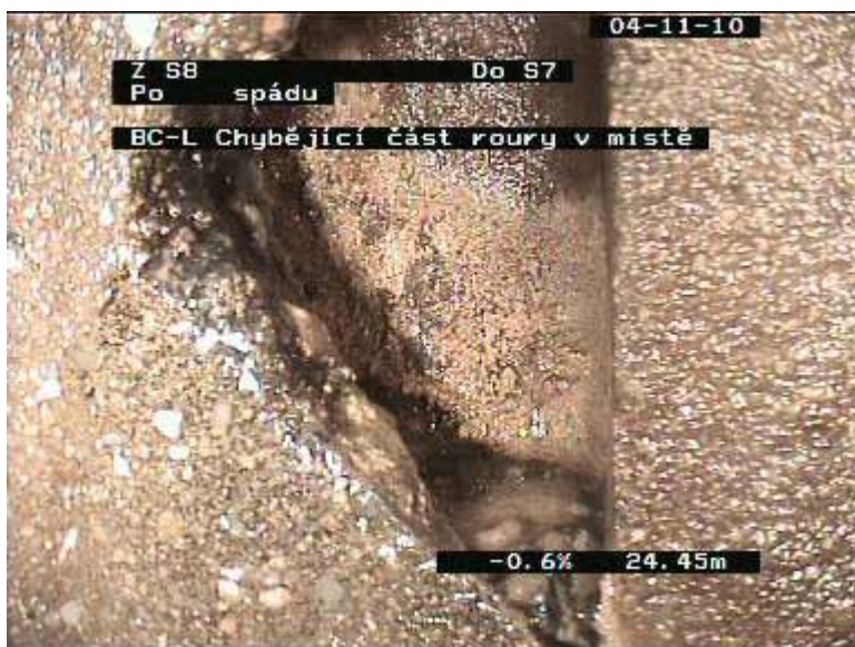
Foto č. 3 – poškozené potrubí ve spoji.
