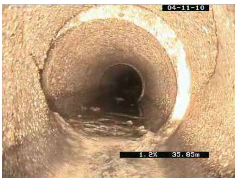
Foto č. 1 – popraskané potrubí na dřívku trouby. Zdroj: z videozáznamu VAS.
