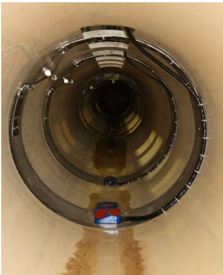
Foto č. 10 – rychlostní sondy ve zkušebním úseku stoky.
