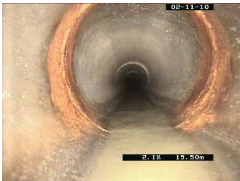
Foto č. 5 – netěsný spoj kanalizace.
