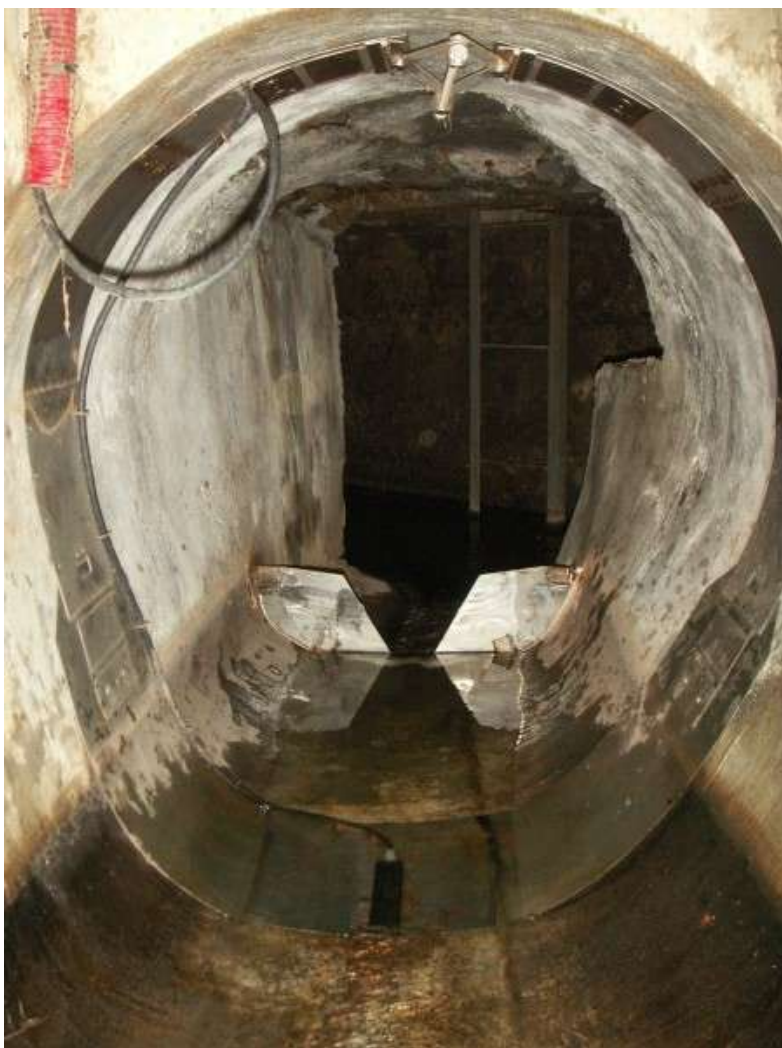
Foto č. 10 – rychlostní sondy ve zkušebním úseku stoky.
