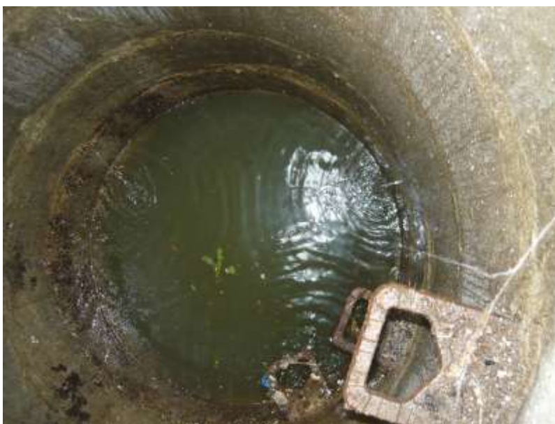
Foto č. 9 – průsak stěnou šachty.
