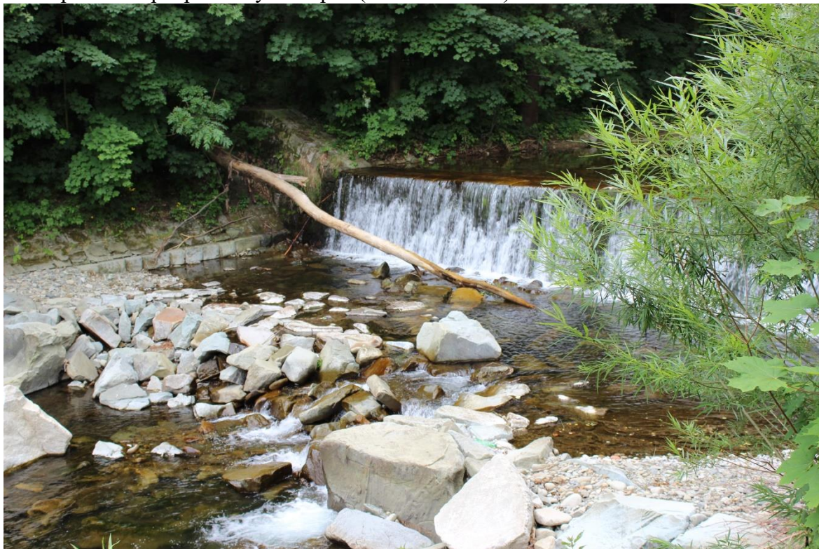
66 Po povodni opět poničený 6. stupeň (V. Průcha 2014)
