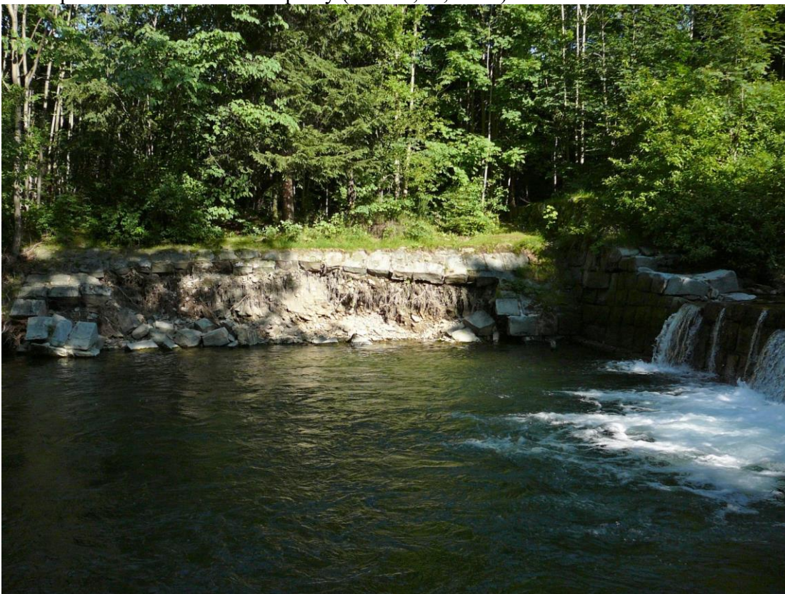
25 Po povodni narušené další splavy (Průcha, V., 2008)
