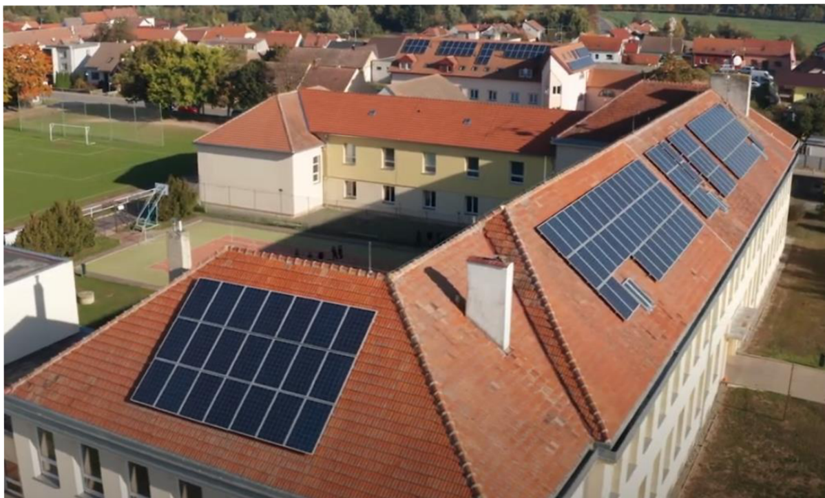
Obrázek 28: FVE na střeše základní školy v Prosiměřicích (zdroj: Hnutí DUHA, 2022)
