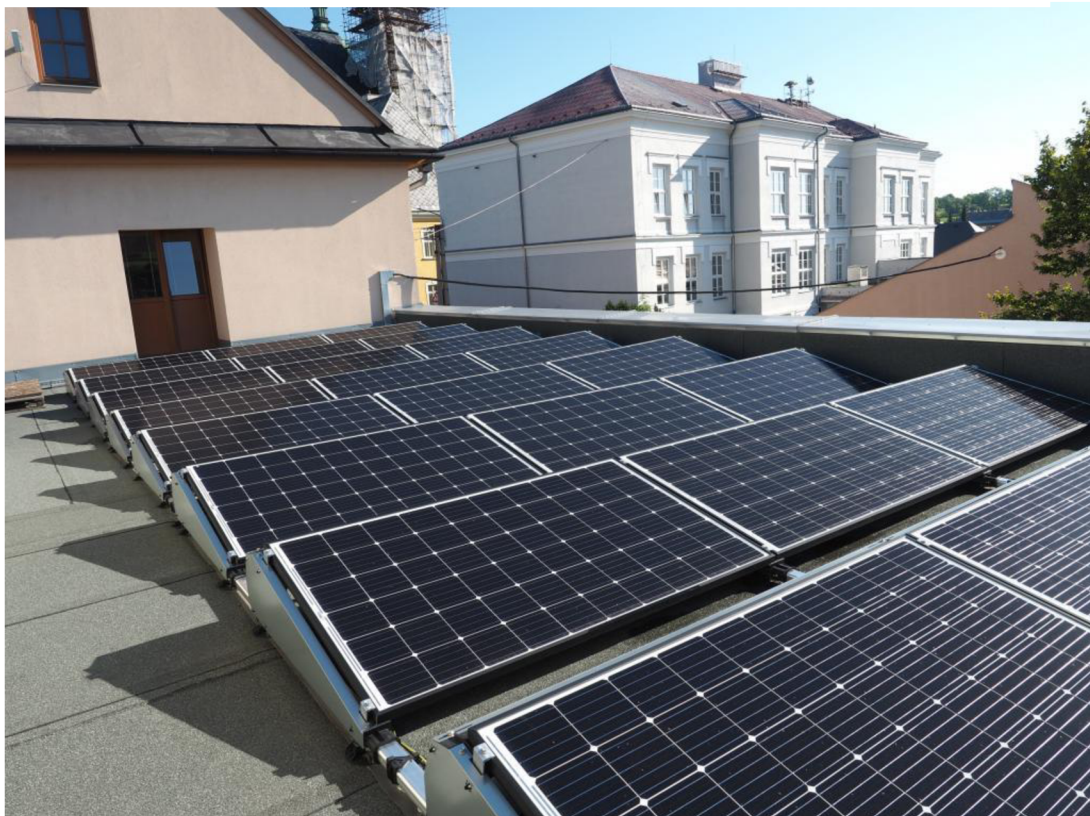
Obrázek 17: FVE na střeše kulturního domu v Budišově nad Budišovkou (zdroj: Budišov, 2023)
