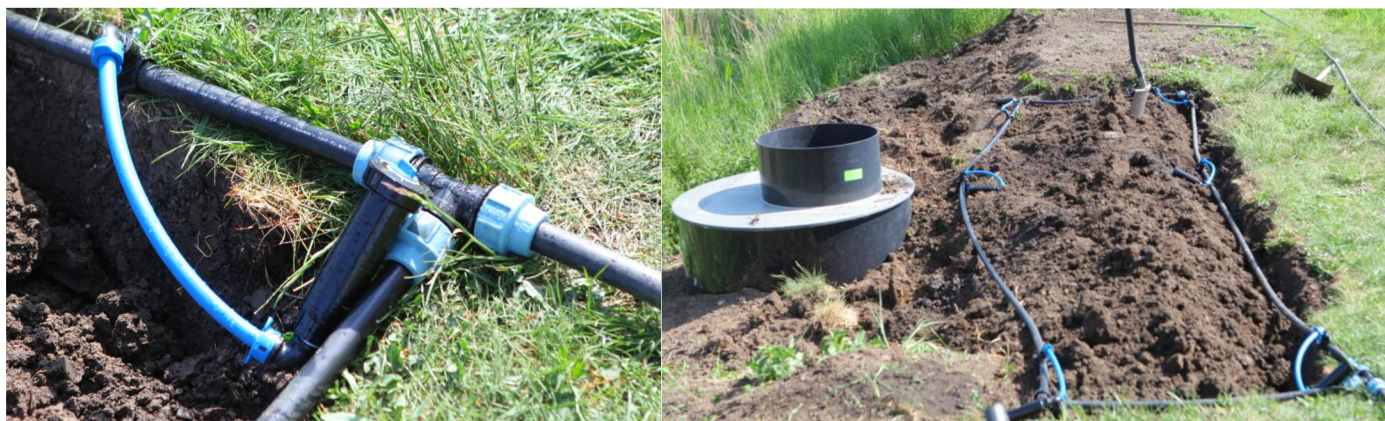
Obrázek 19 - Detail postřikovače, Rozvod závlahového potrubí (Ing. Michal Kriška, Ph.D.)
