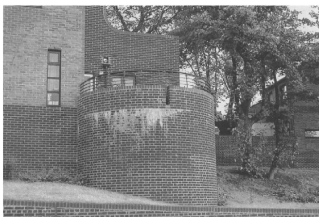
Obr. č. 3 - Ukázka výkvětů na cihlovém zdivu [1]
