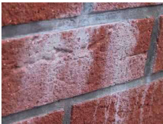
Obr. č. 2 - Ukázka výkvětů na cihlovém zdivu [1]
