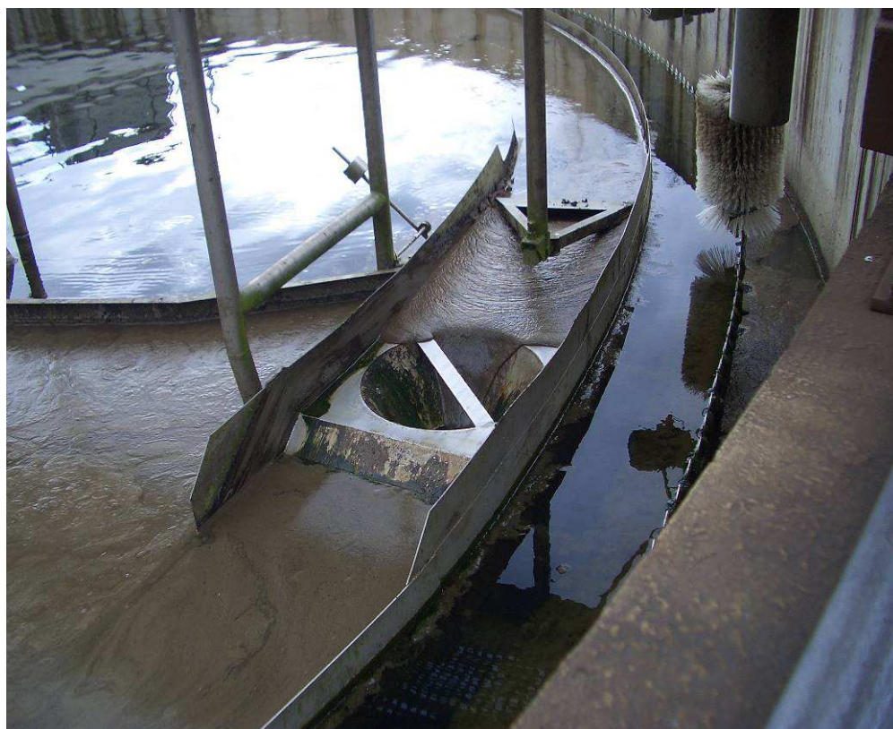
Obrázek 18: Stírání kalu v dosazovací nádrži
