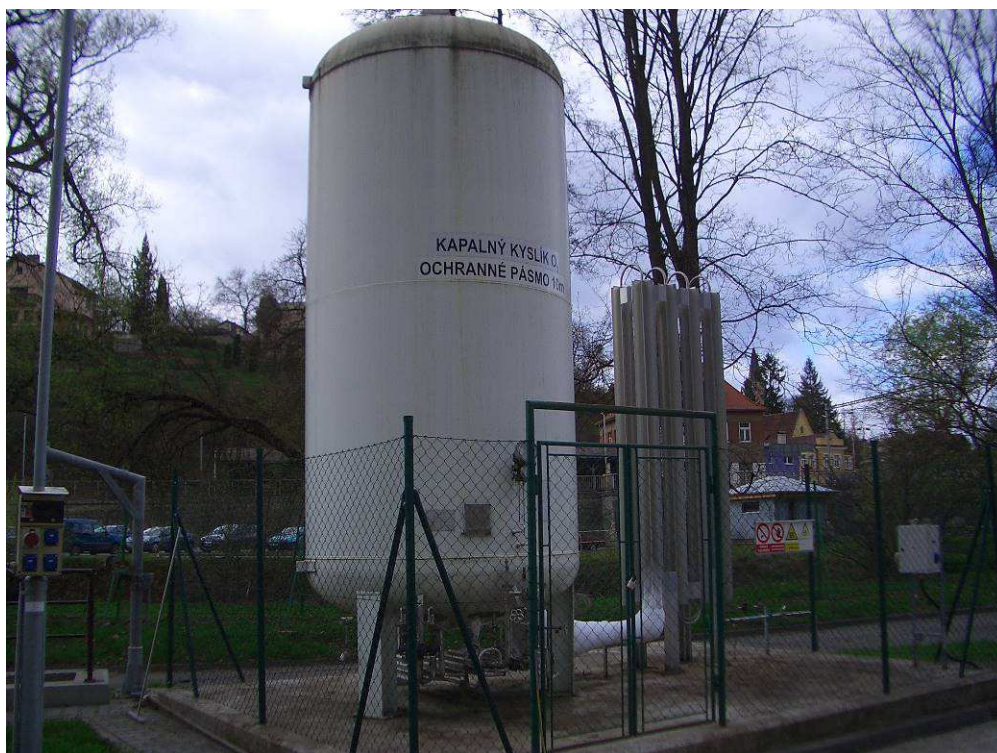
Obrázek 23: Zásobník a odpařovací stanice kyslíku
