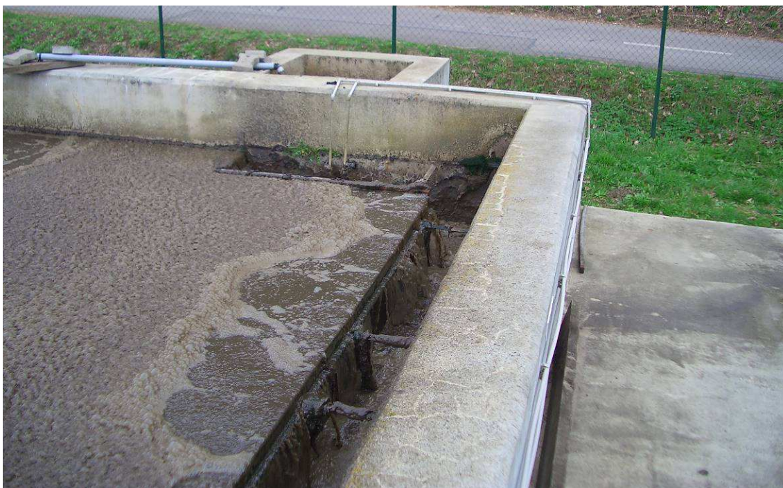
Obrázek 16: Část nitrifikační nádrže, odvzdušňovací odtokový žlab, výtlačné trubičky dávkovacího čerpadla srážedla fosforu
