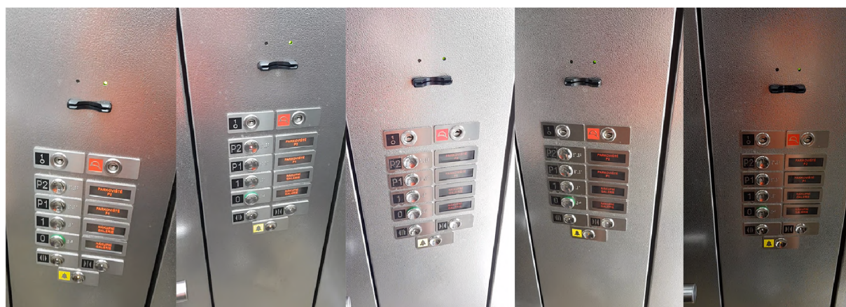
Obrázek 4.2: Koláž digitálních obrazů záznamu ovládací kombinace volby podlaží kabiny výtahu
