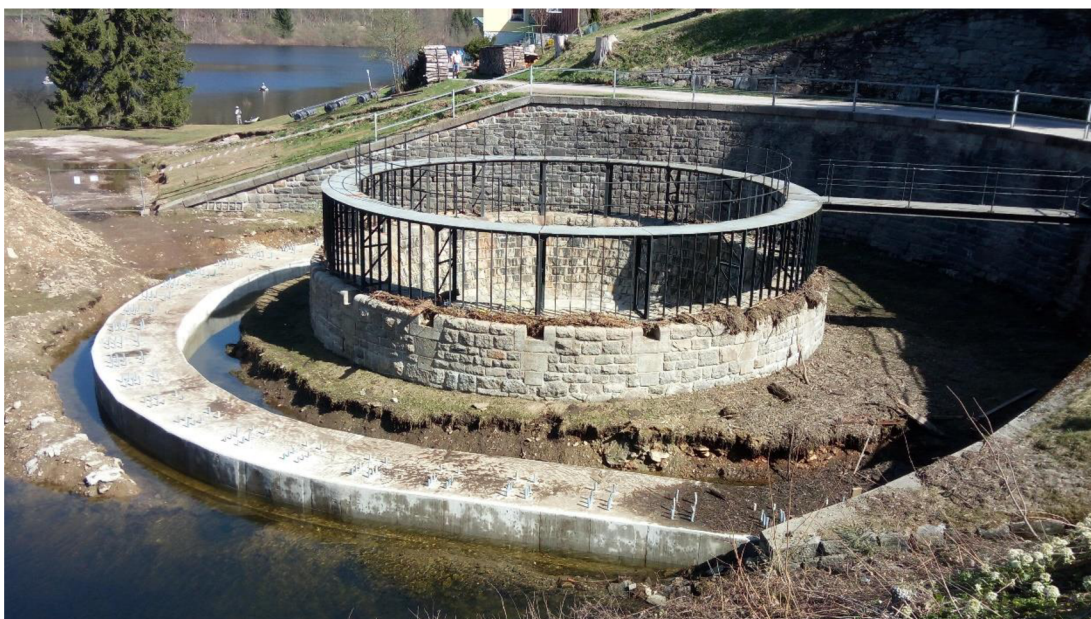
Obrázek č. 15 Právě probíhající osazování hrubých česlí na vodním díle Labská, duben 2018. Autor: vlastní.
