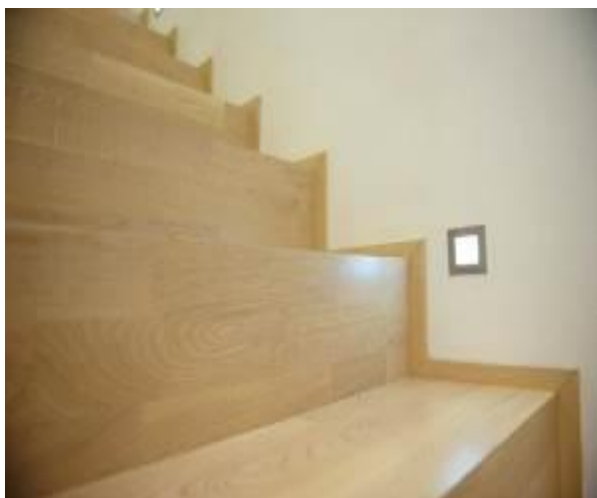
Obr. 6: Osvětlení LED schodiště v posuzovaném EPD Březina
