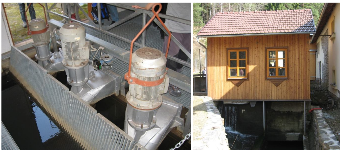
Obrázek 2.8: Malá vodní elektrárna Krásněves (3 násoskové vírové turbíny) [19]
