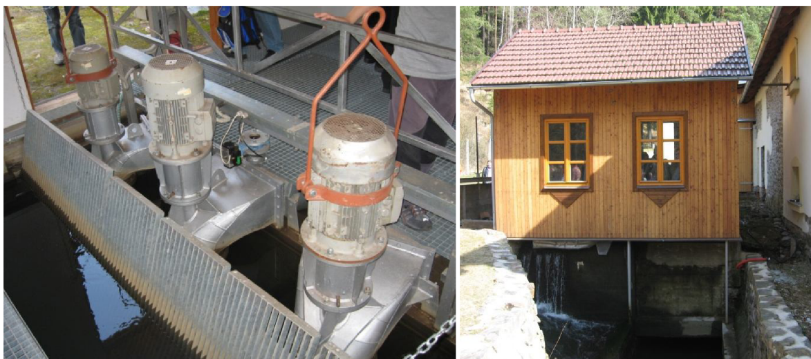
Obrázek 2.8: Malá vodní elektrárna Krásněves (3 násoskové vírové turbíny) [19]
