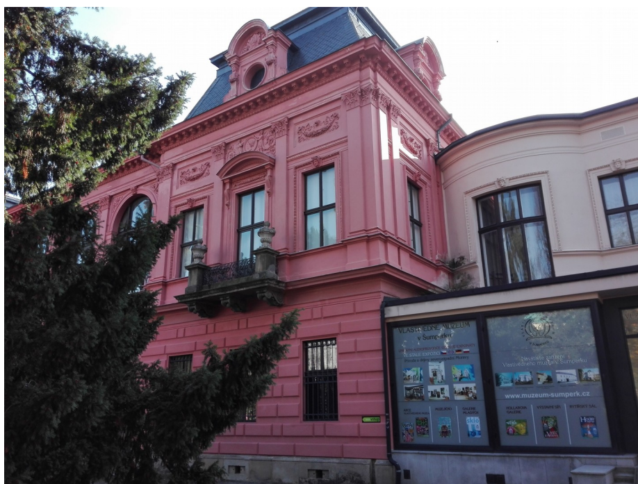
9. Zatékání objektu - detail.
