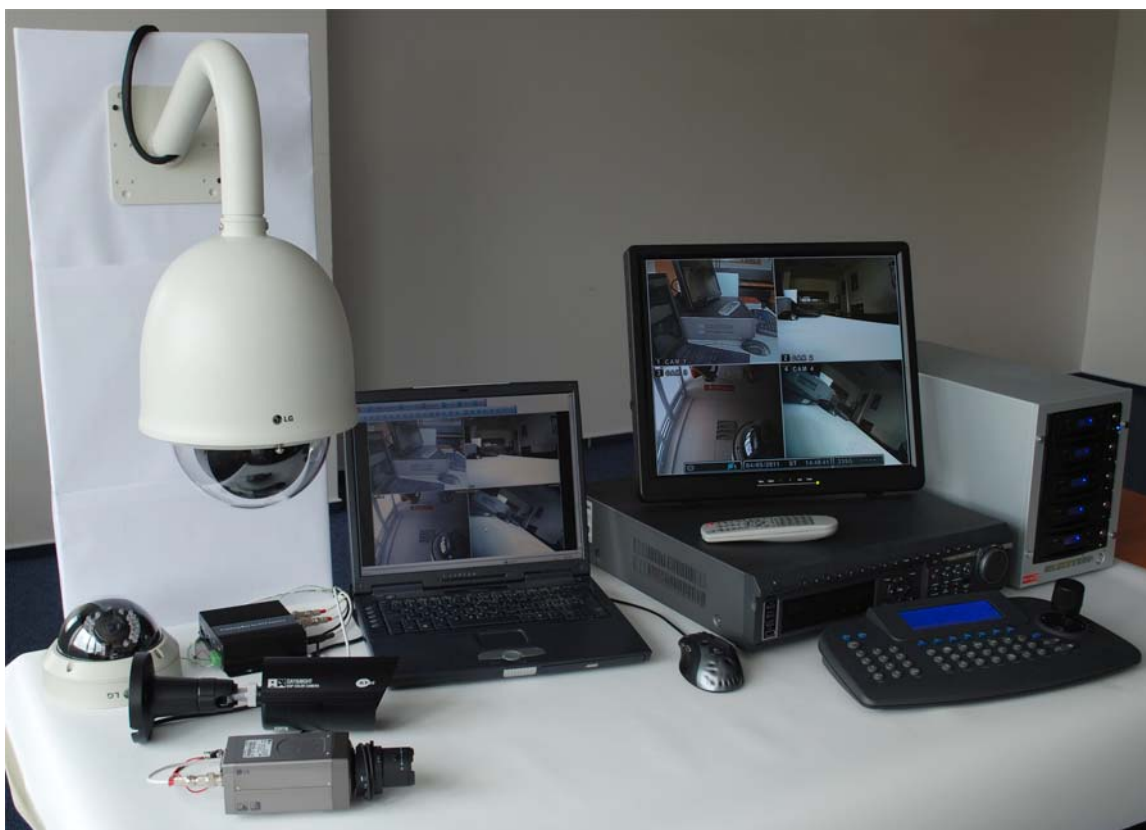
Obrázek D.5: Realizovaný kamerový (CCTV) systém
