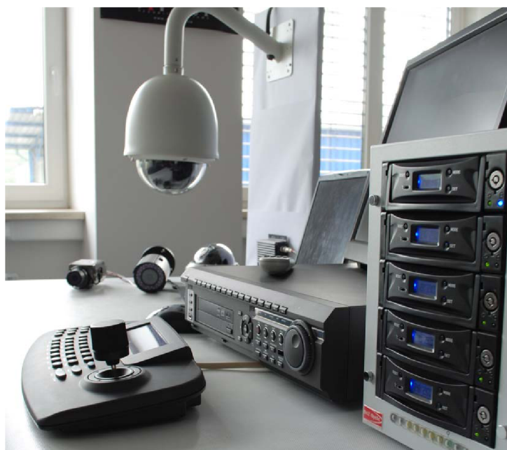
Obrázek D.6: Realizovaný kamerový (CCTV) systém
