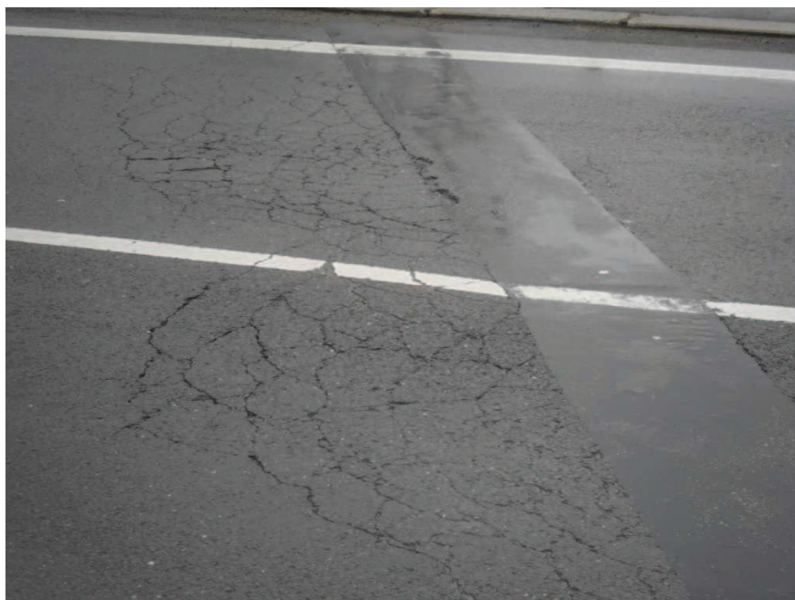
Obr.č.2 Detail trhlin
