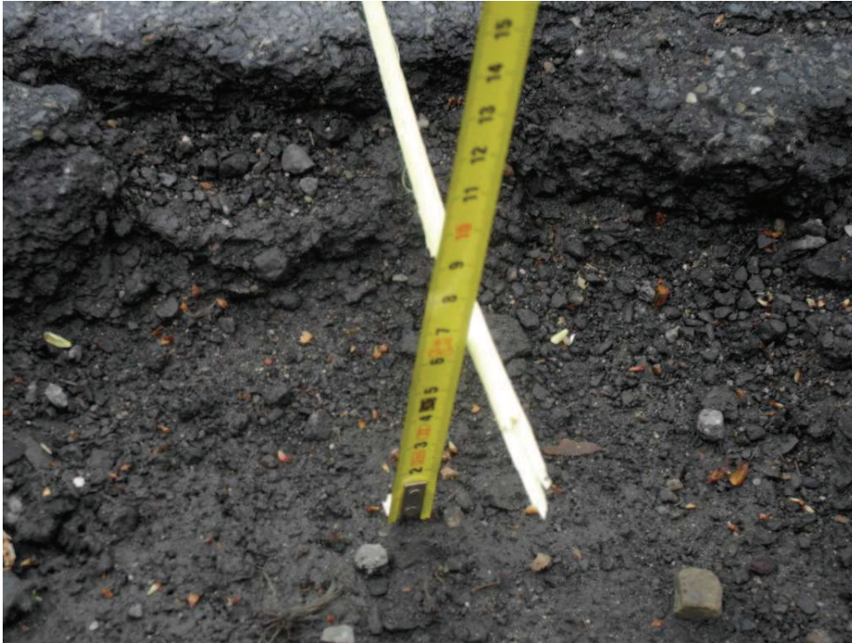
Obr.č.1 Detail výtluku
