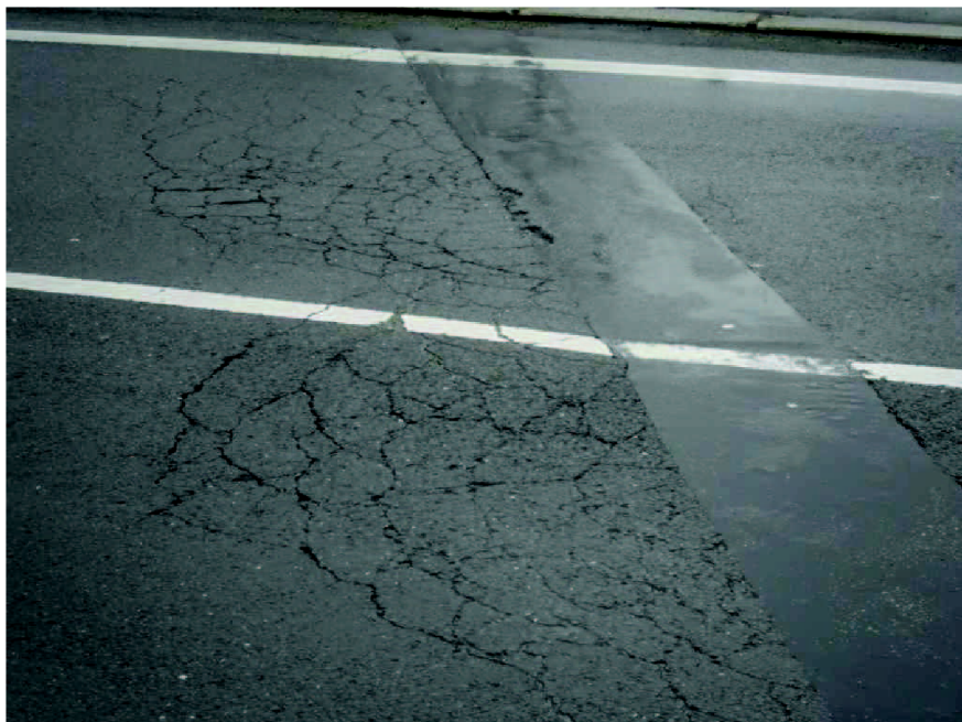
Obr.č.2 Detail trhlin
