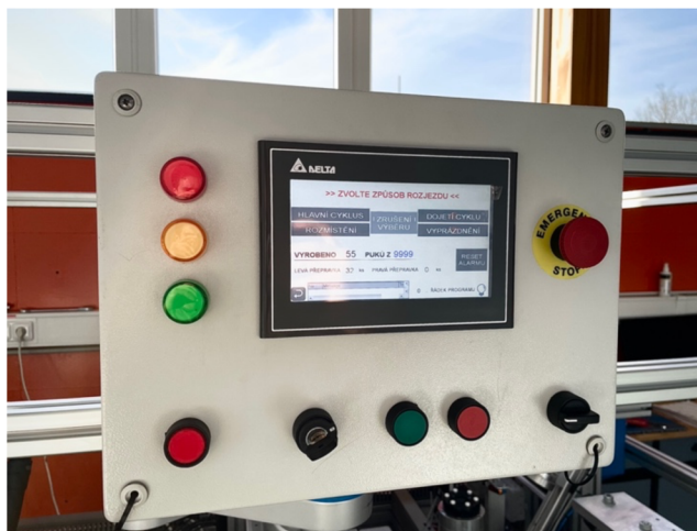
Obr. 36: Ovládací panel robotického pracoviště
