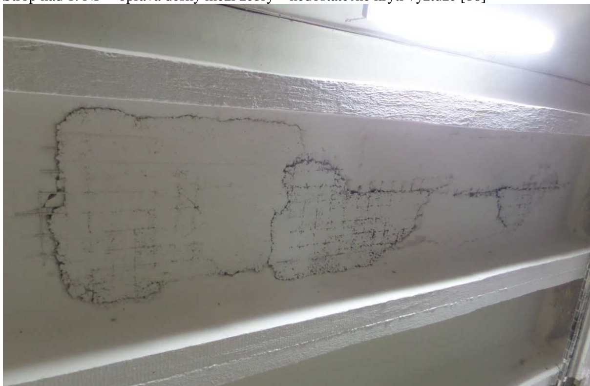
Strop nad 1. NP – oprava desky mezi žebry – nedostatečné krytí výztuže [16]
