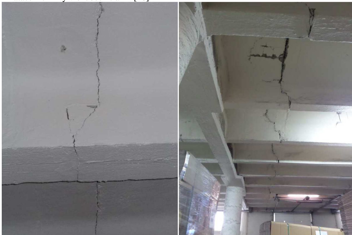
Dilatace – trhliny v ozubech trámů [16]
