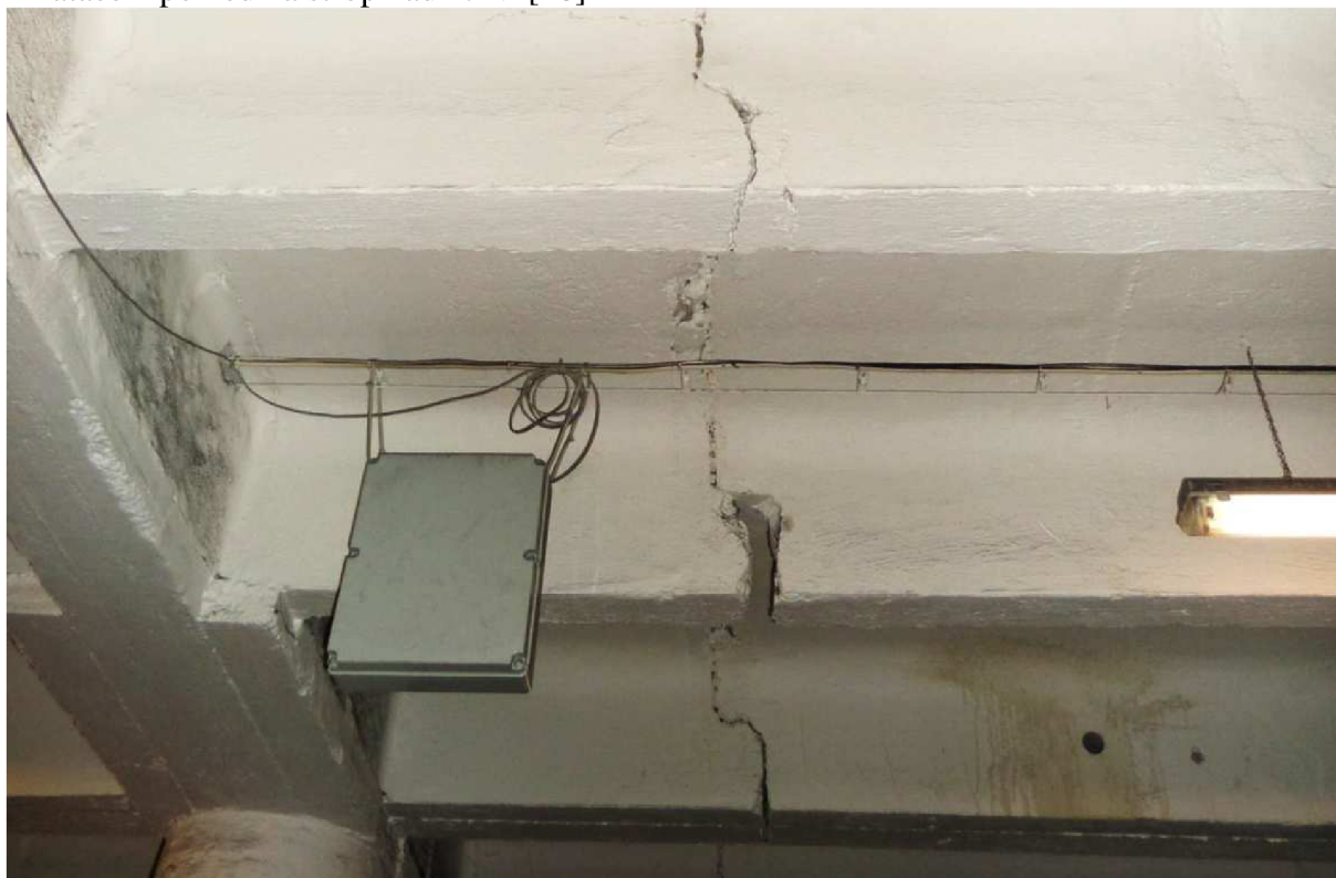
Dilatace – pohled na strop nad 1. NP[16]
