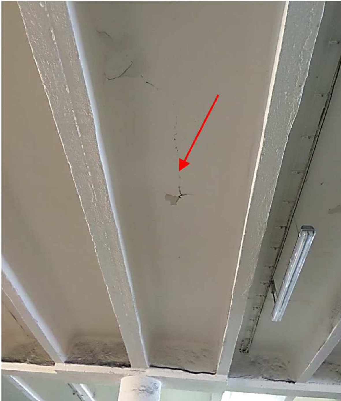
Podélná trhlina v desce mezi trámy (strop nad 1. NP) [16]
