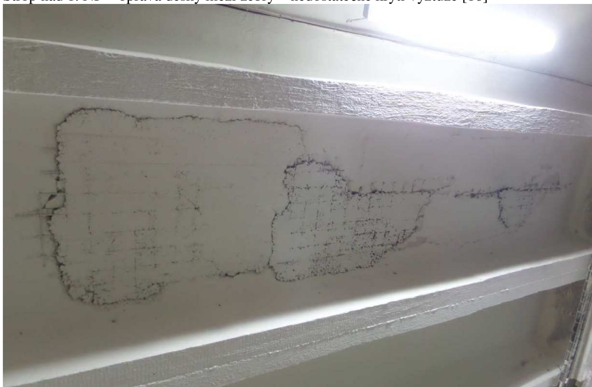
Strop nad 1. NP – oprava desky mezi žebry – nedostatečné krytí výztuže [16]
