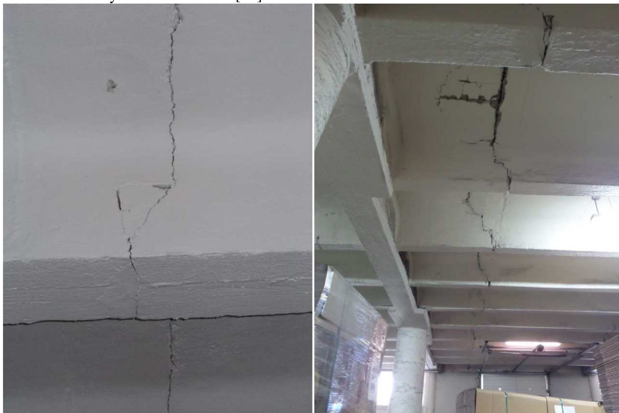
Dilatace – trhliny v ozubech trámů [16]
