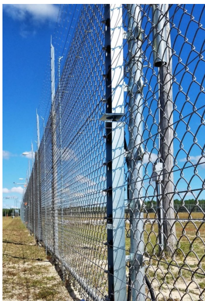
Obr. 5: Realizace tenzometrického detektoru [13]
