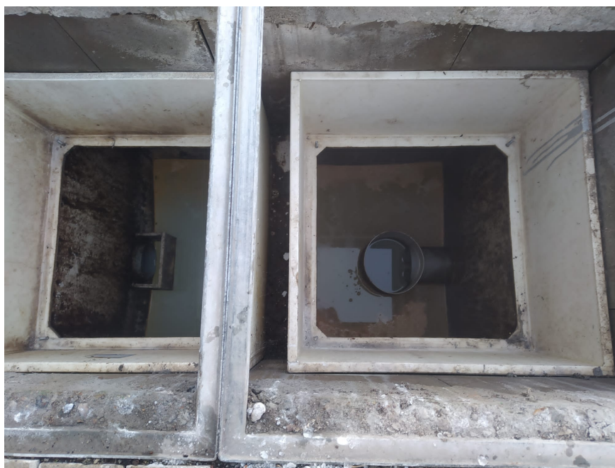
Obrázek 16: Ukázka tukového lapolu před vyčištěním, který je téměř bez tuku (zbytečně častý vývoz)
