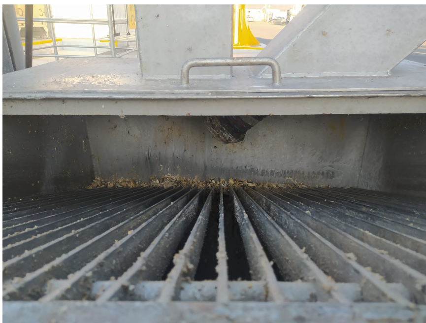
Obrázek 18: Výpustní místo na Ústřední čistírně odpadní vod v Praze pro tukové odpady
