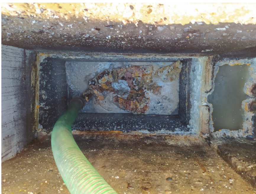
Obrázek 17: ukázka zanedbaného tukového odlučovače (stav tělesa i malá četnost vývozu)
