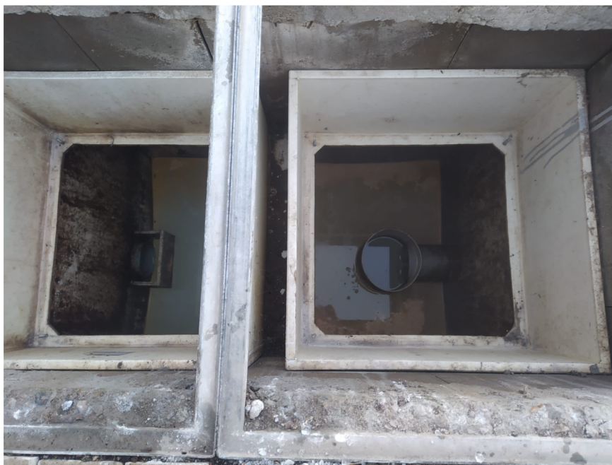
Obrázek 16: Ukázka tukového lapolu před vyčištěním, který je téměř bez tuku (zbytečně častý vývoz)
