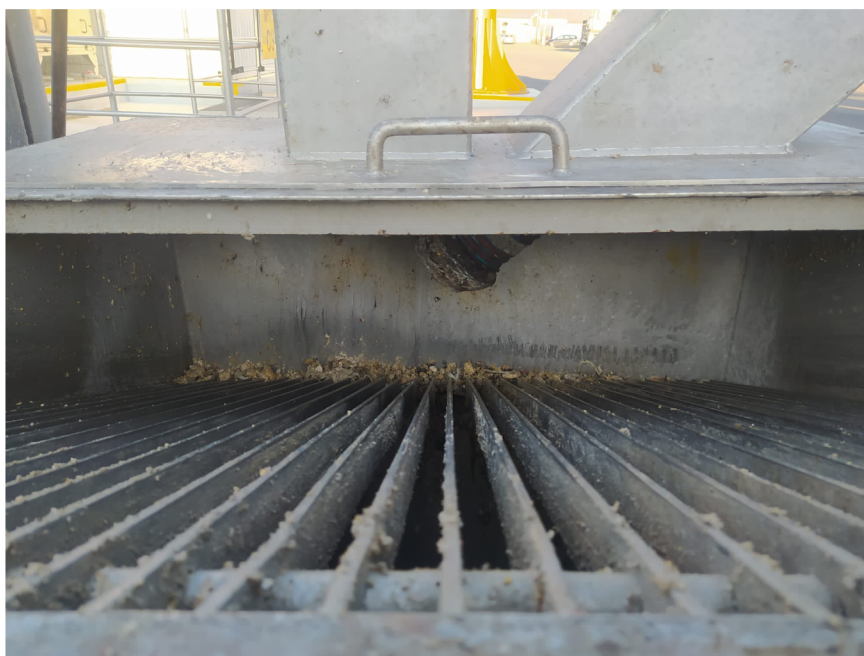
Obrázek 18: Výpustní místo na Ústřední čistírně odpadní vod v Praze pro tukové odpady
