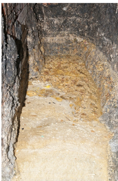
Obrázek 19: Tuk v kanalizaci (PVK, ©2024)
