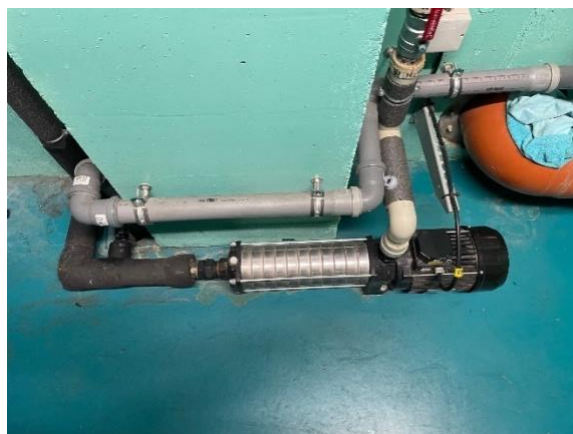
Obr. 13: Čerpadlo (foto vlastní, 2025)
