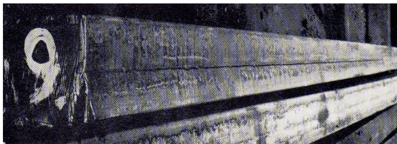
Obrázek 2.4: Podélná trhlina způsobená konkávností a chybnou geometrií krystalizátoru [5]
