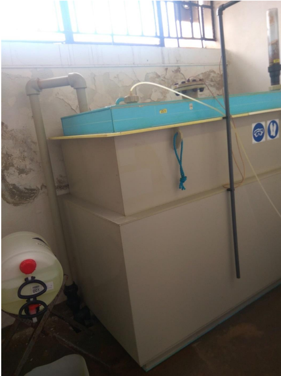
Příloha č. 3 dávkovací zařízení a zásobní kyseliny chlorovodíkové
