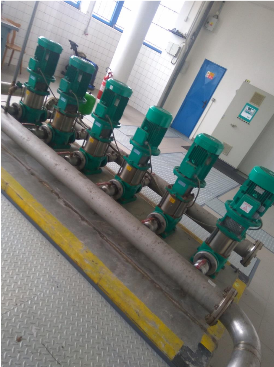
Příloha č. 7 čerpadla sloužící k distribuci pitné vody spotřebitelům LP
