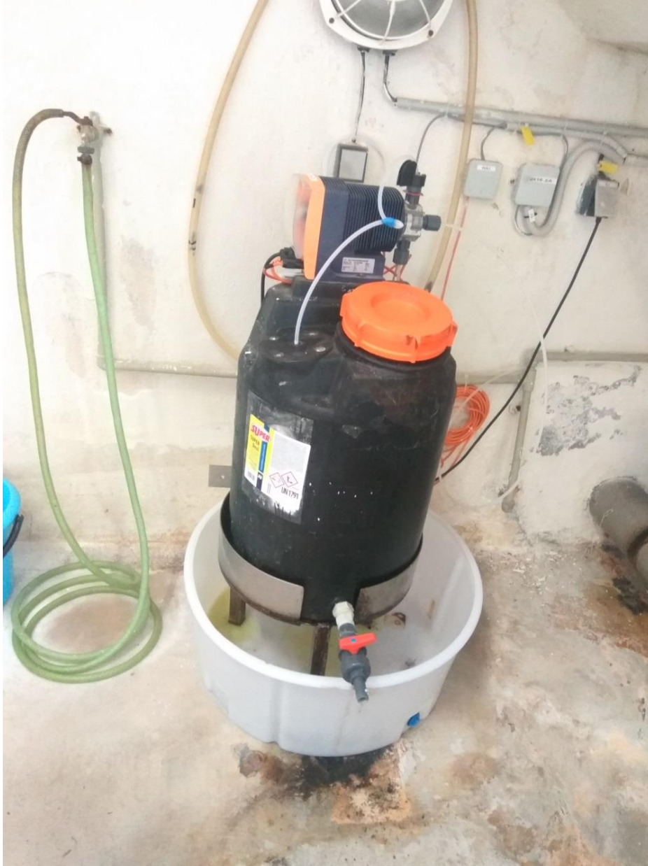
Příloha č. 5 dávkování chlornanu sodného pro hygienické zabezpečení pitné vody
