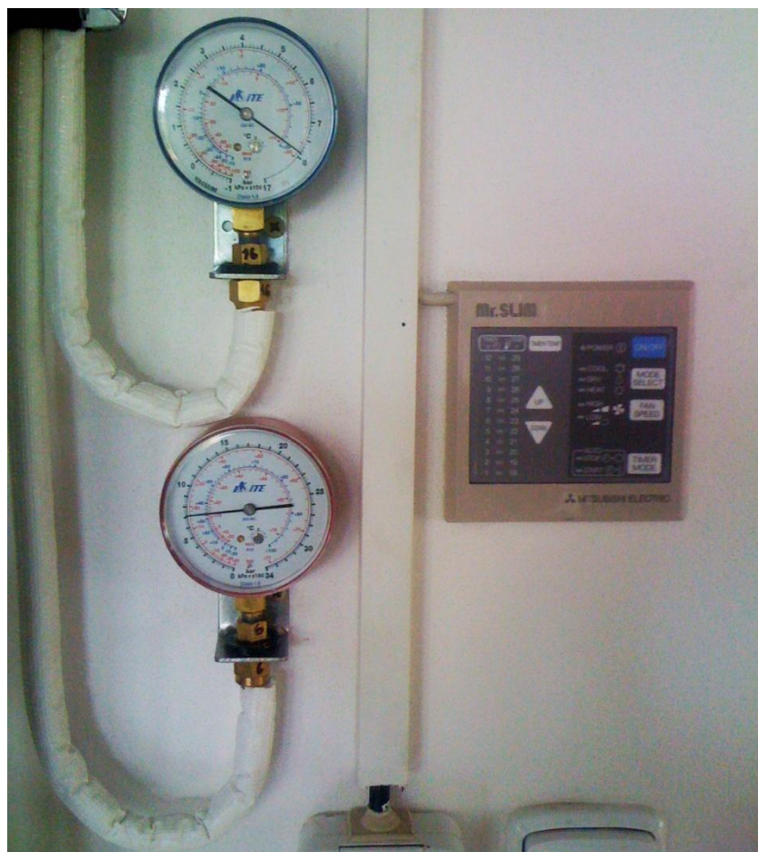
Obr. 9.4:: Foto tlakoměrů (nalevo) a regulačního ovládání jednotky (napravo)
