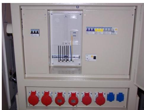
Obr. F.6 Hlavní staveništní rozvaděč RES 2.0.2.4, zdroj: [51]
