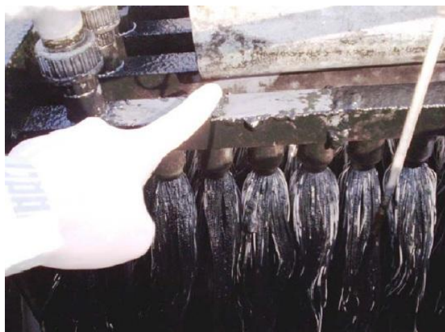
Obr. 7.1 Silně zanesený svazek kapilár [22]
