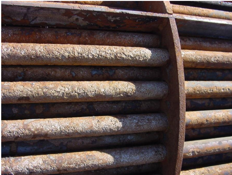
Obrázek 22: Koroze na rekuperačním výměníku tepla
